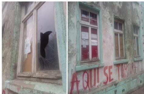
Vandalización Casa de los Derechos Humanos de Punta Arenas.
