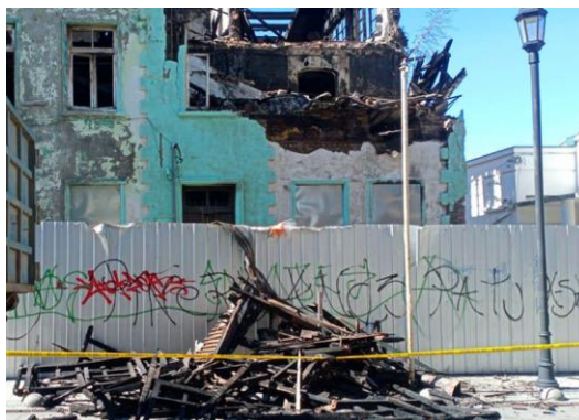
Caída de fachada Casa de los Derechos Humanos, Punta Arenas. Fuente: Sitio Web El Magallánico (17 noviembre de 2020)
