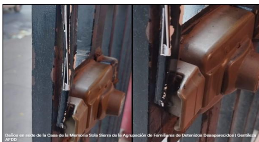
Destrucción Casa Memoria Sola Sierra, Santiago.
