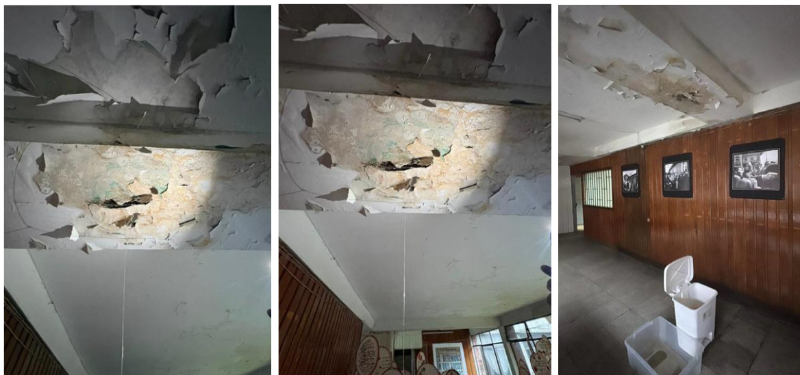
Deterioro estructural Sitio de Memoria Ex Cuartel CNI (Miraflores 724)
