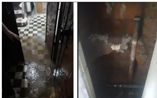
Destrucción Ex Clínica Santa Lucía. Fuente: Informe denuncia CMN.
